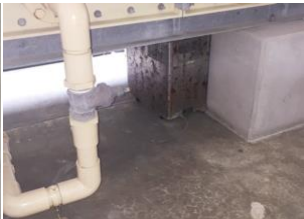
受水槽下に投棄ゴミ有り
