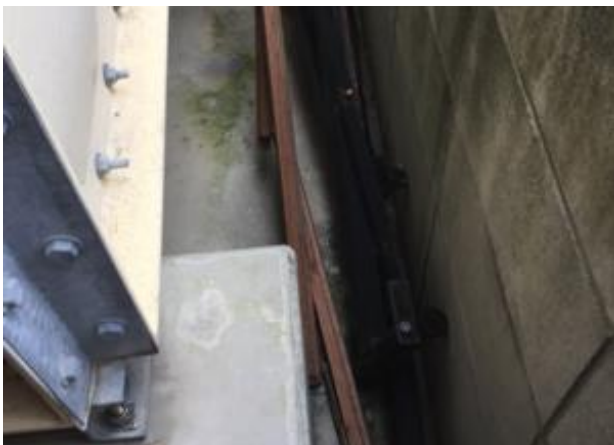
受水槽廻りに投棄ゴミ有り
