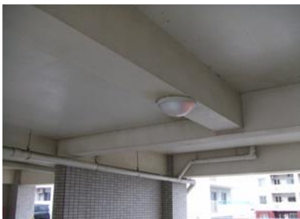
共用灯不点灯 (1F右駐車場中央)
