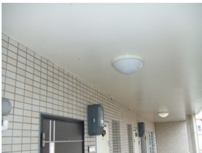
202号前照明切れ
