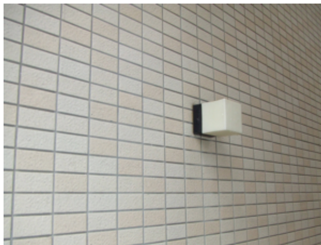
エントランス玄関入口照明切れ
