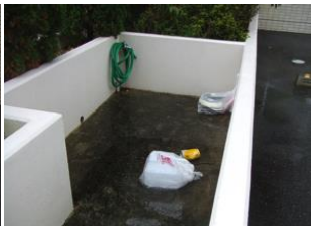
ゴミ置場ゴミあり
