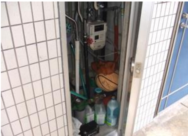
A-3号室パイプスペース
