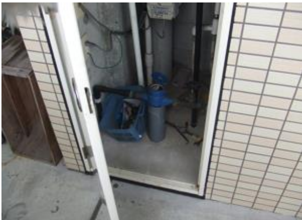
205号室パイプスペース
