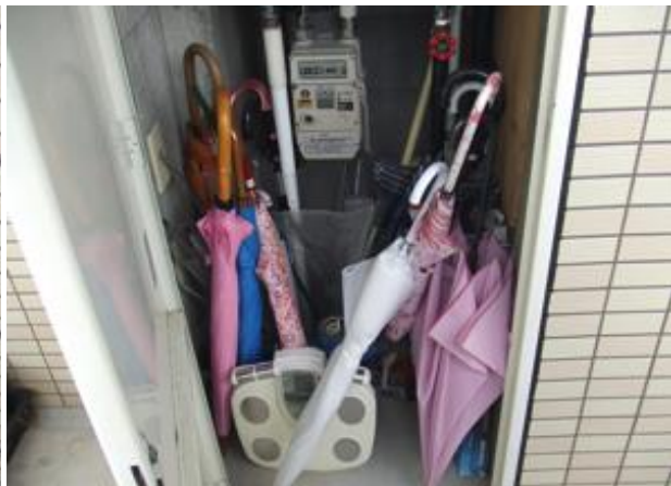
207号室パイプスペース
