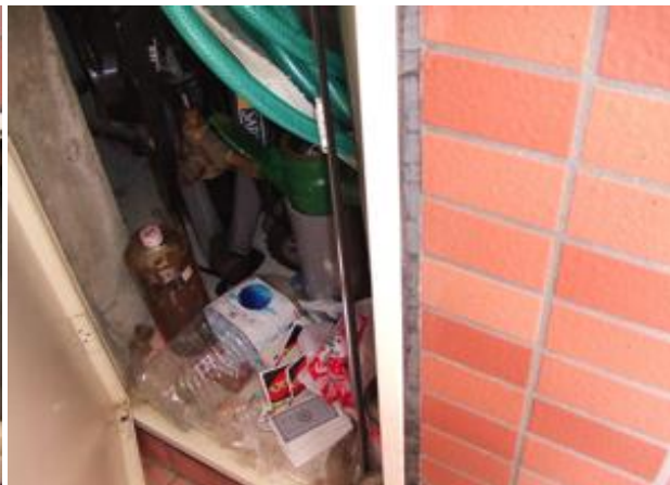
102号室パイプスペース
