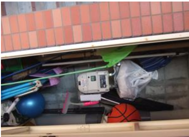
201号室 パイプスペース
