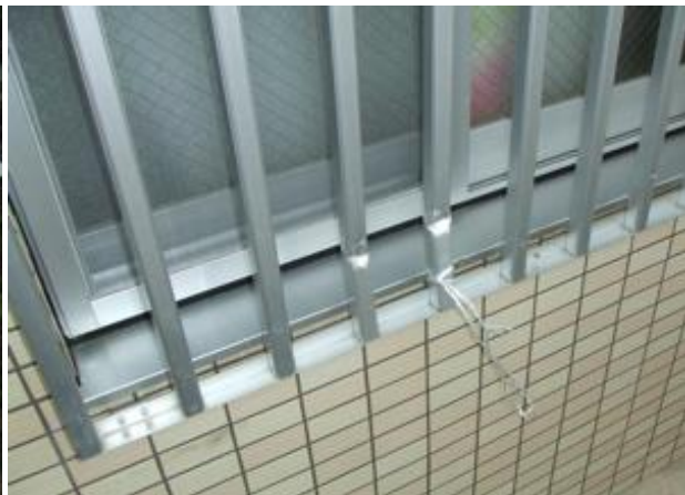
面格子破損あり
