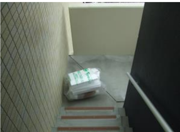
非常階段に放置ごみあり
