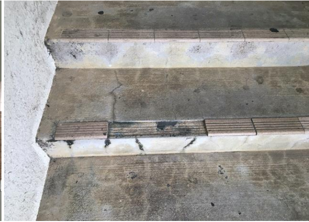
階段のタイルが数カ所剥がれてています。
