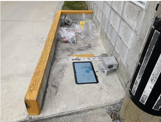
ゴミ置場・未回収ゴミあり。
