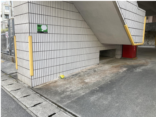
ゴミ置場・未回収ゴミあり。
