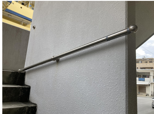
1F~2F階段の手すり破損しています。
