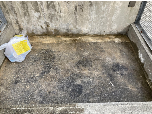
ゴミ置場・未回収ゴミあり。
