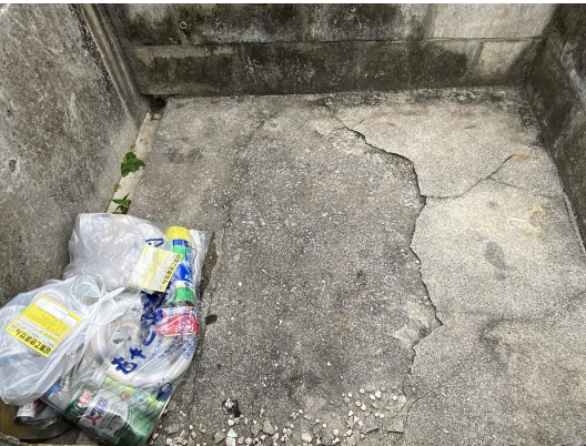
ゴミ置場・未回収ゴミあり。
