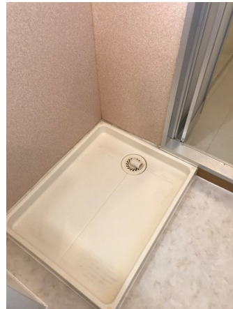
6.洗濯機防水パン
