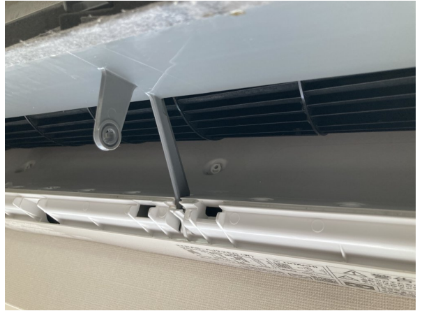
16.エアコンクリーニング
