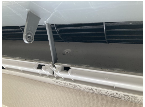
16.エアコンクリーニング
