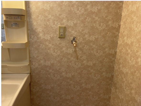
6.洗濯機防水パン
