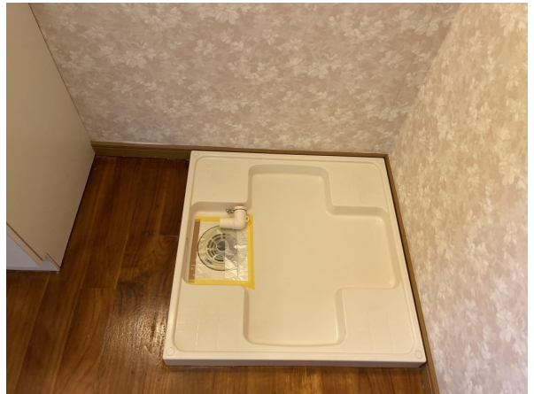
6.洗濯機防水パン
