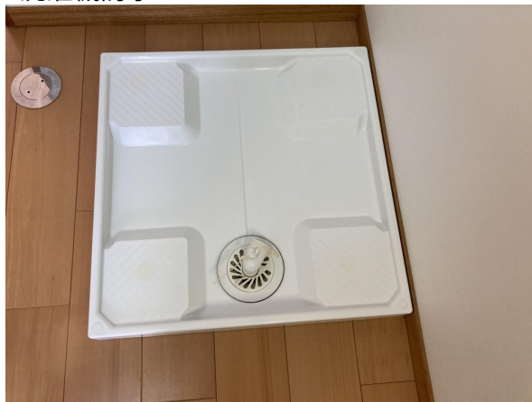
5.洗濯機防水パン
