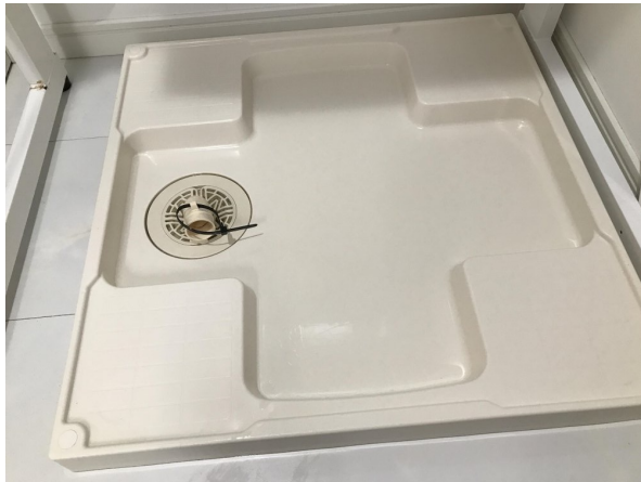
8.洗濯機防水パン
