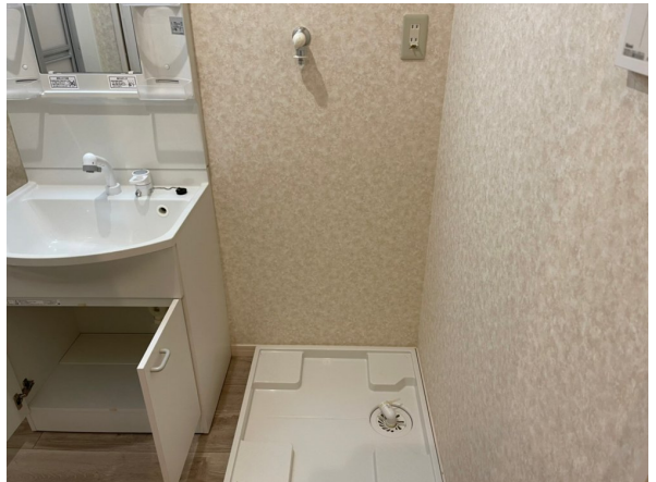
6.洗濯機防水パン
