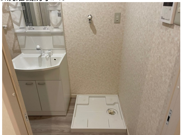
6.洗濯機防水パン
