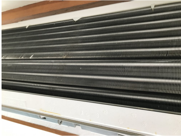
1.エアコンクリーニング
