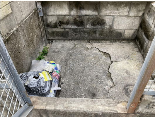
ゴミ置場・未回収ゴミあり。
