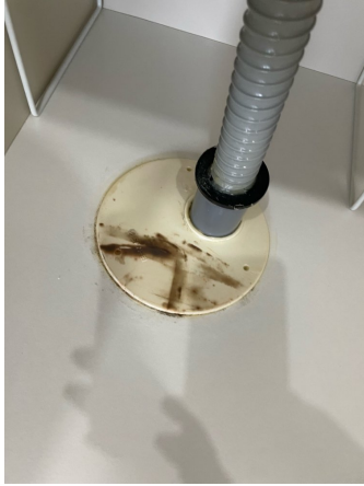
シンク下の棚汚れ有り
