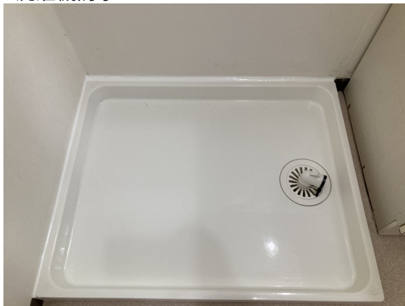
6.洗濯機防水パン
