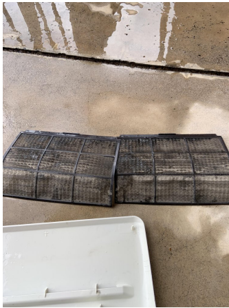
15.エアコンクリーニング
