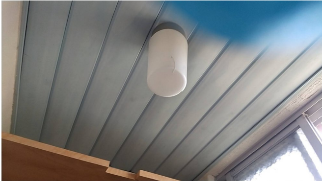
トイレ照明ひび割れ有り
