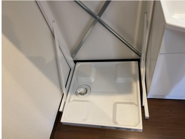
7.洗濯機防水パン
