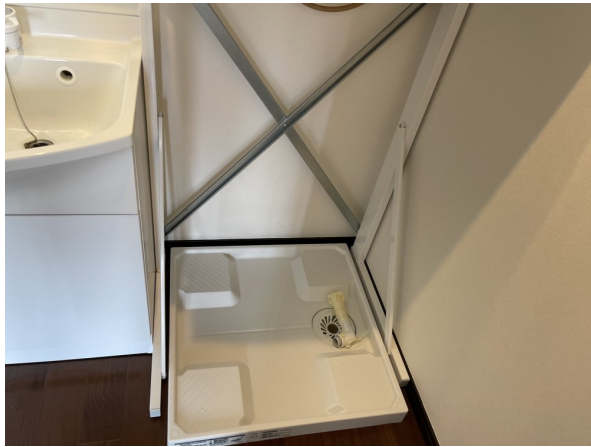
7.洗濯機防水パン
