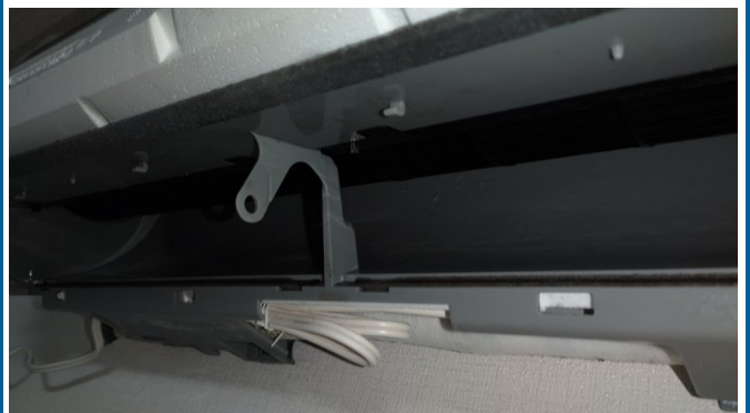
15.エアコンクリーニング
