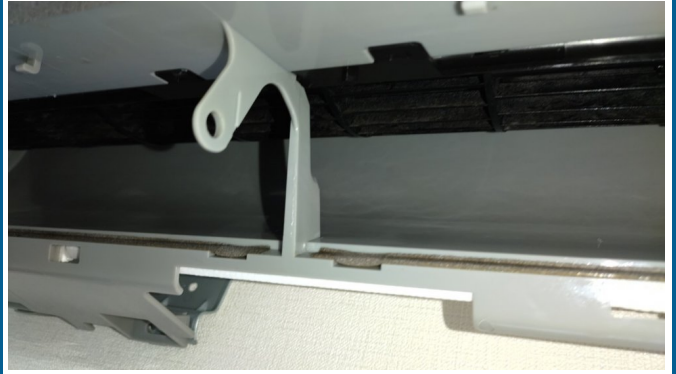
14.エアコンクリーニング
