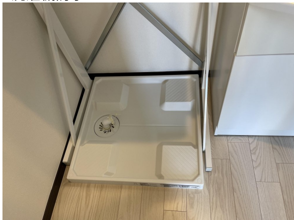
7.洗濯機防水パン
