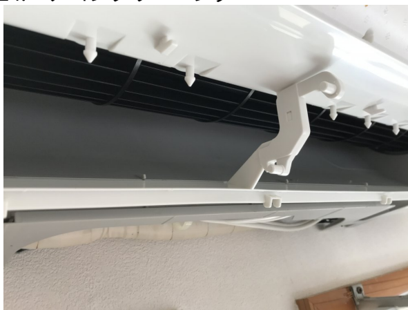
14.エアコンクリーニング
