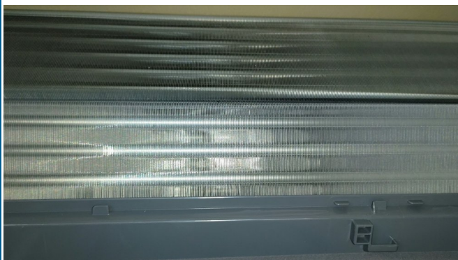
15.エアコンクリーニング
