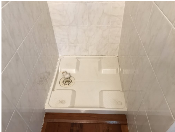
7.洗濯機防水パン
