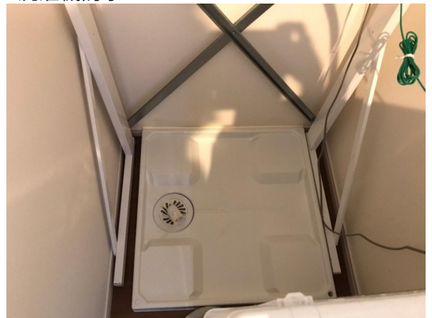
5.洗濯機防水パン
