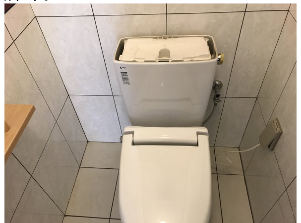
タンク水栓レバー故障
