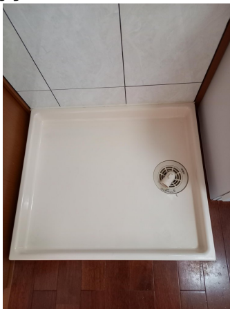
6.洗濯機防水パン
