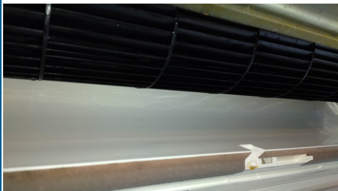
15.エアコンクリーニング
