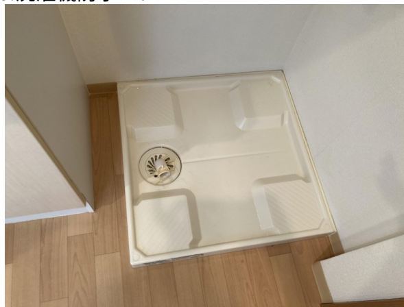
8.洗濯機防水パン
