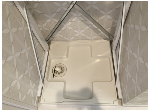
8.洗濯機防水パン
