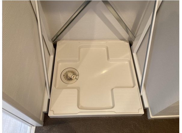
7.洗濯機防水パン
