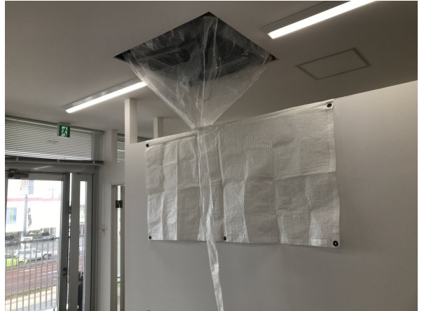
7.エアコンクリーニング
