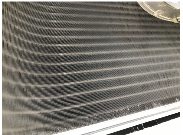
7.エアコンクリーニング
