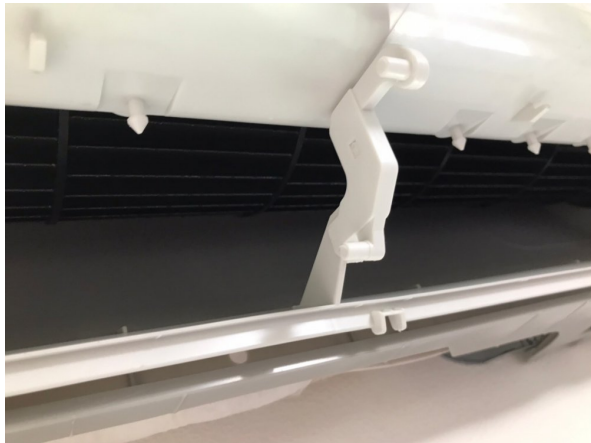
14.エアコンクリーニング
