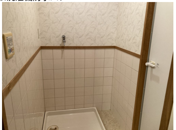
3.洗濯機防水パン
