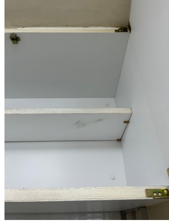
キッチン上の棚剥がれ有り
