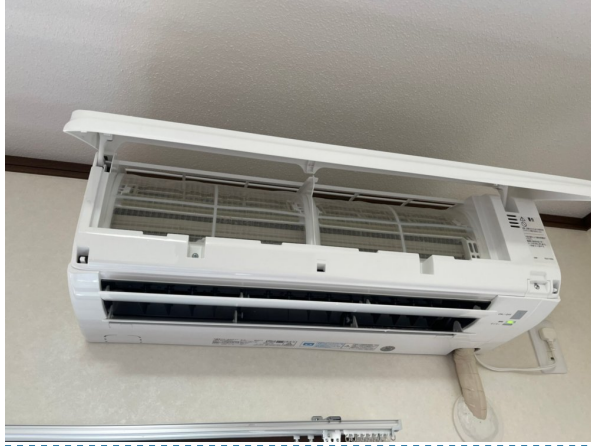
15.エアコンクリーニング
