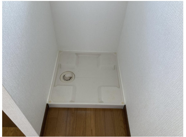
5.洗濯機防水パン
