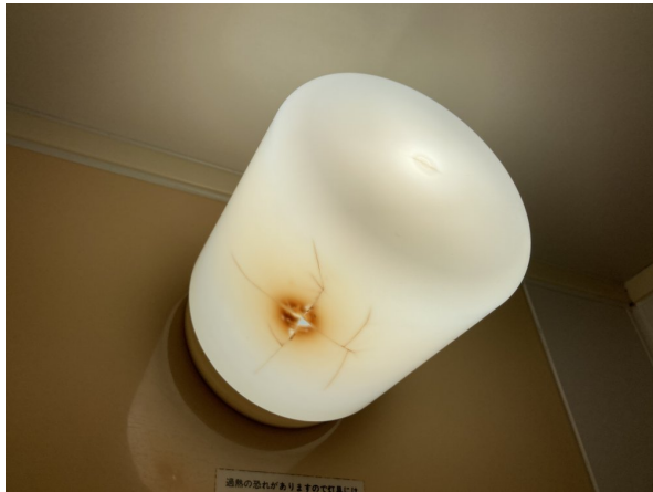
照明割れ有り
