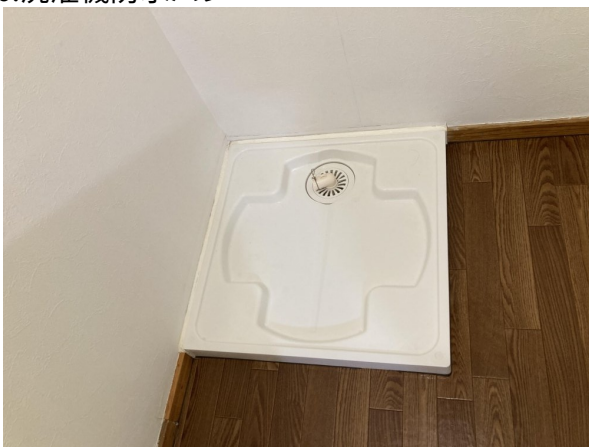
6.洗濯機防水パン
