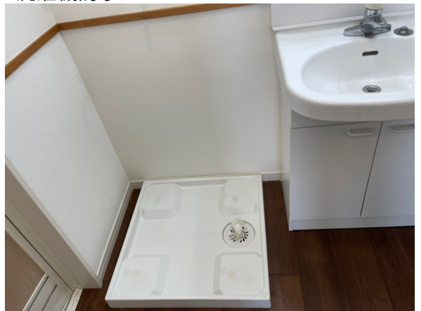
6.洗濯機防水パン
