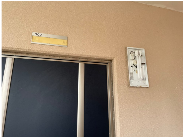
302号室特殊電球ツイン蛍光灯
