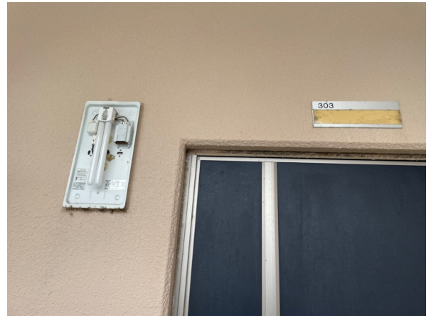
303号室特殊電球ツイン蛍光灯
