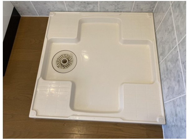
6.洗濯機防水パン
