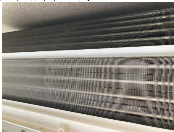
9.エアコンクリーニング
