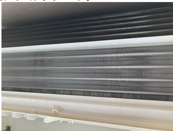
9.エアコンクリーニング
