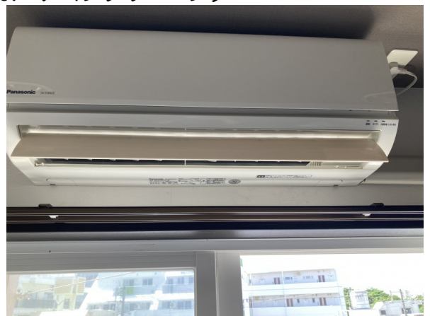
9.エアコンクリーニング
