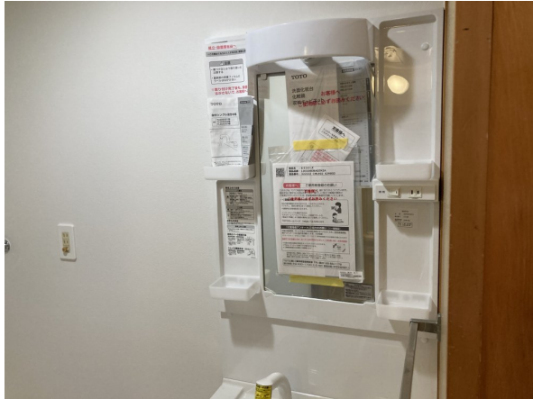
洗面台取替済み
